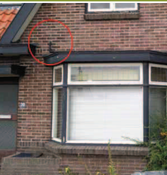
Figuur 1: Een foutieve aansluiting van een badkamer op regenafwatering.
